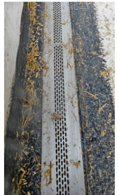
Lochblechrinnen am Ende der Bucht leiten Flüssigkeiten rasch ab. Das Stroh-Kot-Gemisch wird am Auslaufende in einen Querkanal geschoben.
